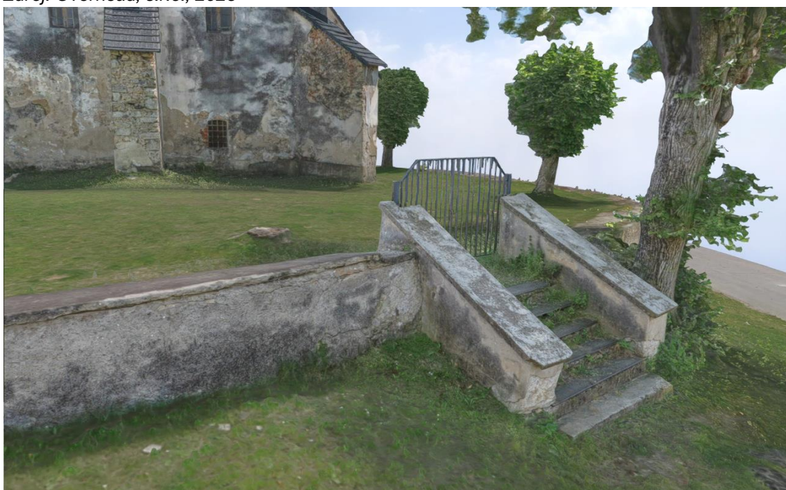
Obr. č. 20: Vizualizácia exteriérových prvkov – severná strana areálu s nevyhovujúcim stavom schodov, omietok ohradného múru a neudržiavanými alebo odstránenými drevinami. Zdroj: Overhead, s.r.o., 2023
