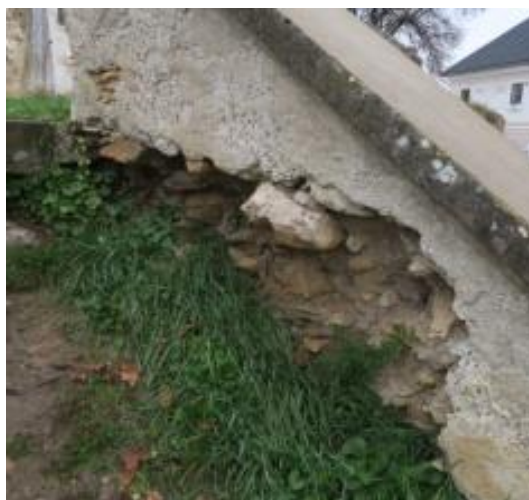
Obr. č. 15, 16, 17: Statické poruchy múru: trhlina, naklonenie steny, podmyté základy schodiska. Zdroj: ProMonumenta
