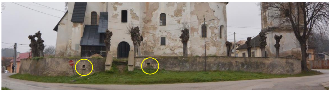
Obr. č. 12: Pohľad na múr z juhu s 2 ks odvodňovacích otvorov. Zdroj: ProMonumenta
